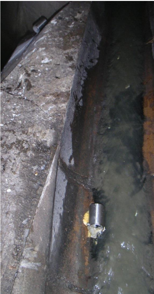
Abbildung 190: Eingebaute Temperatursensoren in einem Weizer MWÜ
